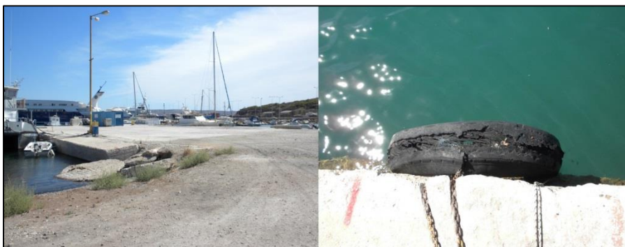
Εικόνα 4. Κατεστραμμένα κρηπιδώματα και φθαρμένοι προσκρουστήρες
